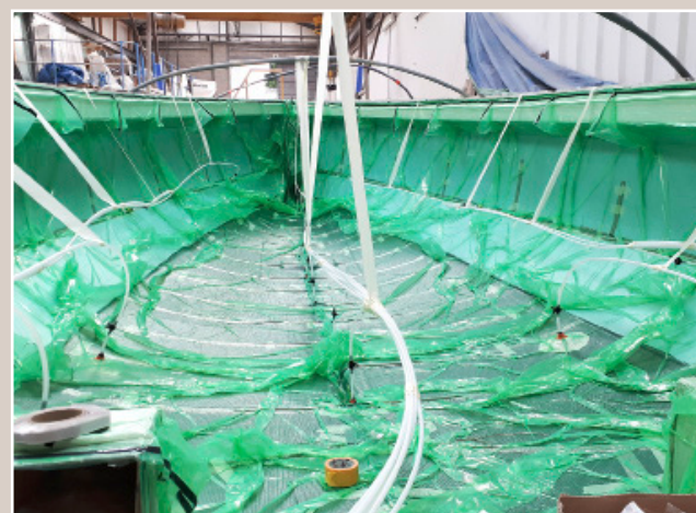
▲ Les matériaux changent mais pas la méthode de construction. Comme les autres, Mojito Virgin est mis en œuvre sous infusion.
